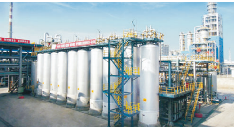
镇海炼化30000Nm 3 /h干气回收乙烯装置
