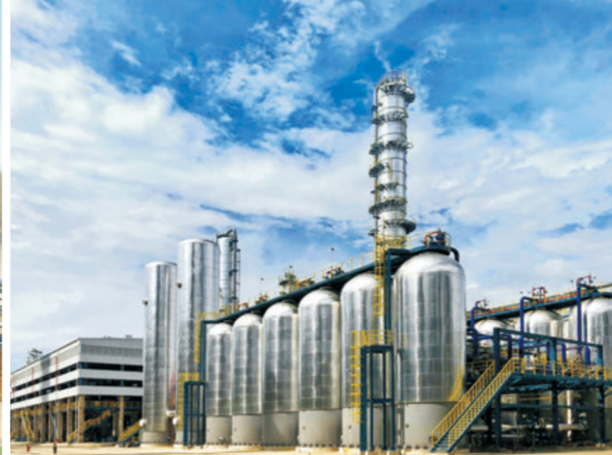
恒逸文莱220000Nm 3 /h重整气提纯氢气装置
