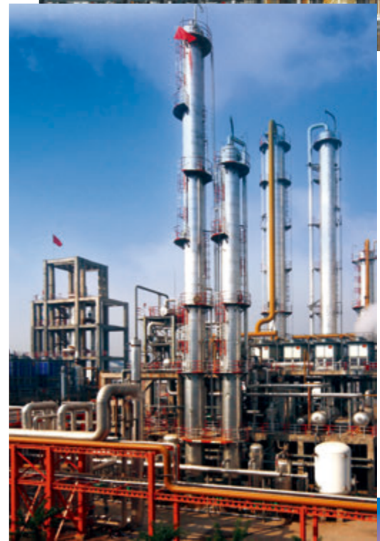
山西同世达 200kt/a焦炉气制甲醇装置
